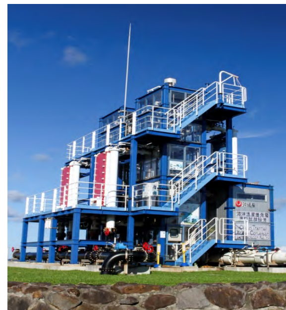
久米島で稼働中の 50kW海洋温度差発電 (OTECHP)
